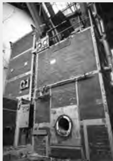
Technická pamiatka zachovaná na pôvodnom mieste v objekte kotolne - Sulzerova pec, typ z roku 1943, zo slávnej švajčiarskej firmy z Winterthuru, jediná na Slovensku.
